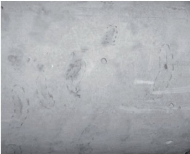
Figura 17: Textura lisa y fisuras.
