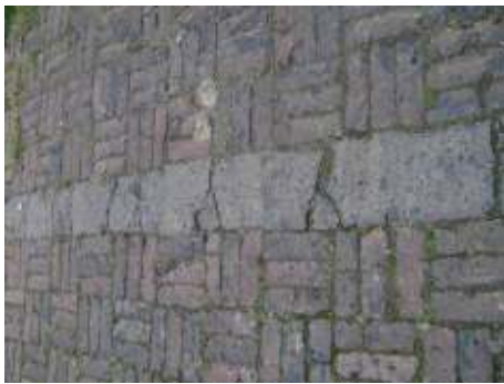
Figura 13. Desplazamiento de juntas
