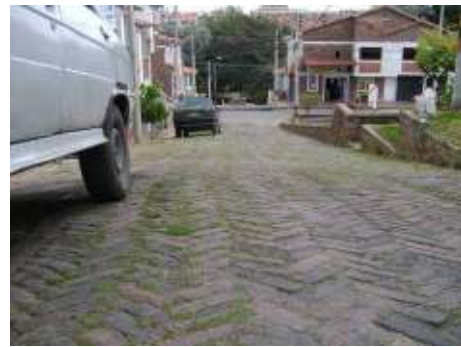
Figura 17. Desplazamiento de juntas
