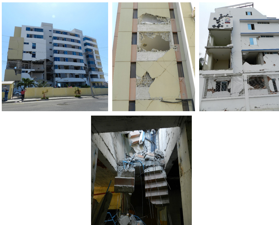
Figura 1. Caída de fachadas y escaleras en el sismo de Ecuador de 2016
