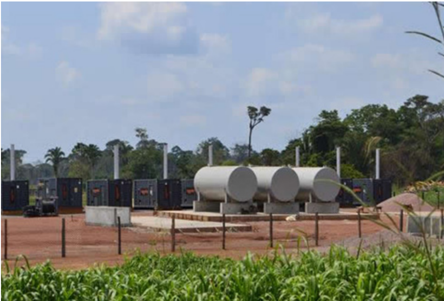
Figura 1. Usina Térmica de Vista Alegre do Abunã
